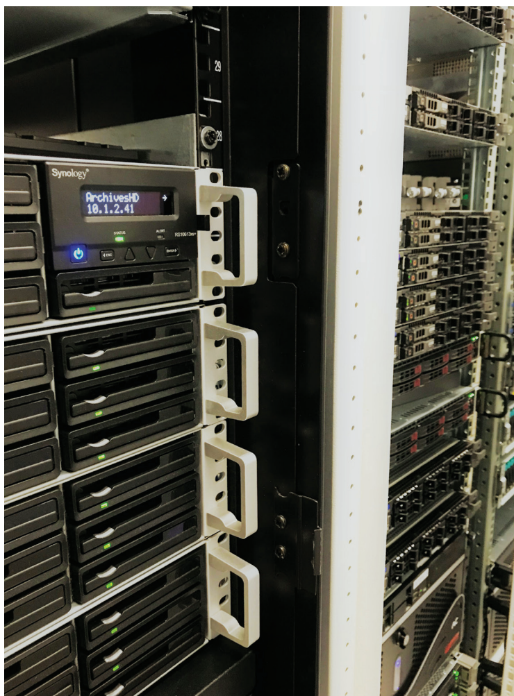
Salle serveur où sont stockées toutes les archives de Canal9 / Kanal9 depuis 1984
